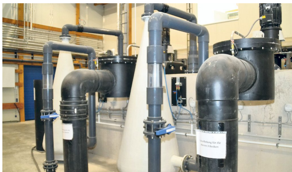
Die ausgefeilte Technik sorgt für einen Wasserkreislauf, so dass nur minimale Wassermengen durch Verdunstung und Arbeitsschritte aus dem System heraustropfen.
