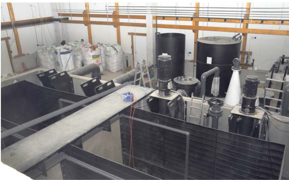
Der Technikum mit den Filteranlagen nimmt ebenfalls Formen an. Gut zu sehen sind inzwischen auch die Holzelemente, die der Halle eine besondere Struktur verleihen.
