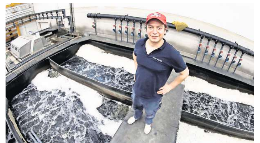
Gründer Tarek Hermes inmitten der Filteranlage: Mit Hilfe von Bakterien wird das fortlaufend umgewälzte Wasser der Zuchtbecken gereinigt.
